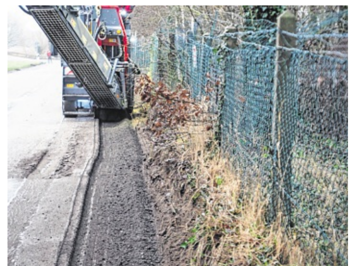
Eine Maschine fräst die Oberfläche der Fahrbahnkante an der K 22 ab. Der Rand ist brüchig geworden. Ob die Arbeiten bis heute abgeschlossen werden können, ist fraglich. Foto: Klaus Plath
